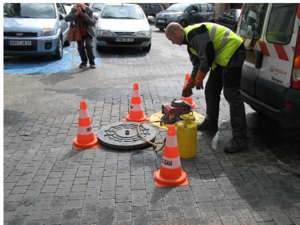
Figure 2 : test à la fumée lors d'un contrôle de conformité
